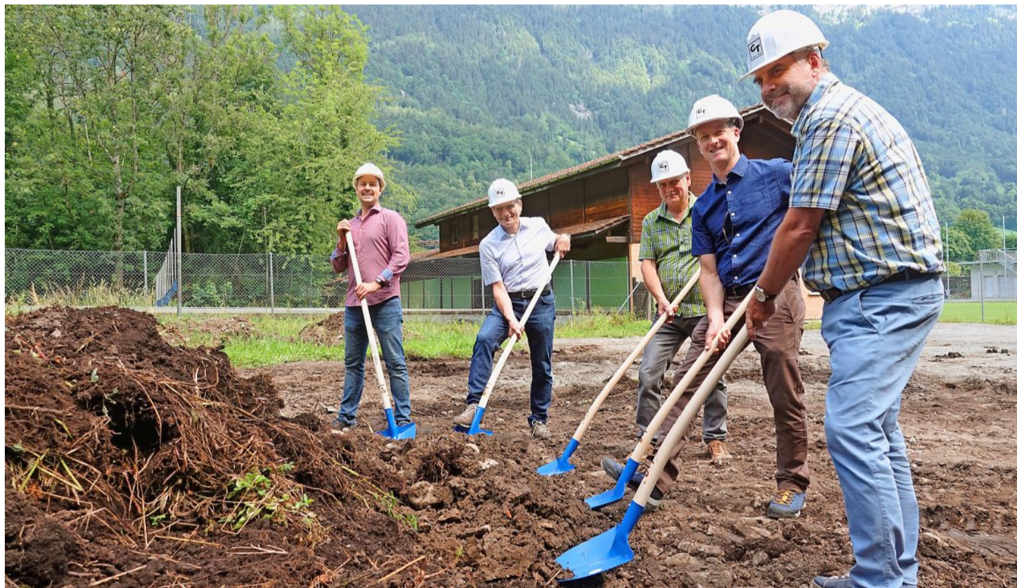
Spatenstich zum Neubau einer Heizzentrale im Wärmeverbund Ringgenberg (v.l.): Jürgen Weber (Projektleiter Triplex AG), Peter Aeschmann (Präsident Avari AG), Samuel Zurbuchen (Gemeindepräsident Ringgenberg), Martin Amacher (Mätzener & Wyss) und André Chevrolet (Gemeindeschreiber Ringgenberg). Foto: Bruno Petroni
